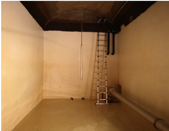
LED-Innenbeleuchtung Reservoir Weierweid
