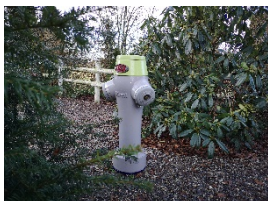
Hydrant Parkplatz Restaurant Frohsinn, 8908 Hedingen
