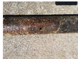
Korrosion am Gussrohr
