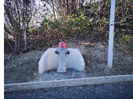
Hydrant Nr. 112, Güpfstrasse
