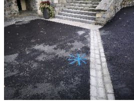
Wasser-Rohrbruch Vor Treppenaufgang Kirche
