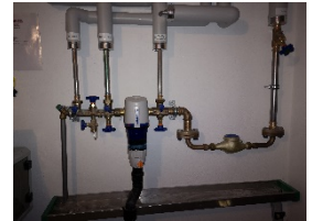
Wasserzähler-Ablesung wie es sein sollte
