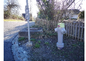
Hydrant Nr. 119, Gehrstrasse - Frohmoosstrasse
