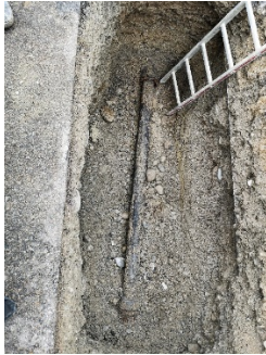
Ursache: Korrosion am Gussrohr
