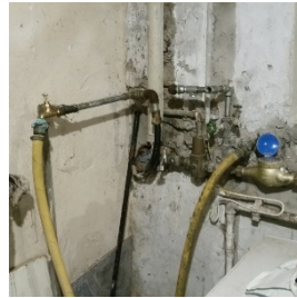
Wasserzähler-Ablesung mit beschwerlichem Zugang
