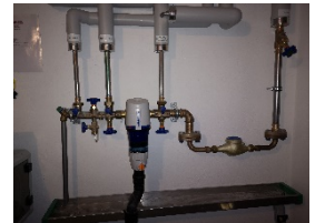
Wasserzähler-Ablesung wie es sein sollte
