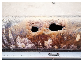
Korrosion am Gussrohr
