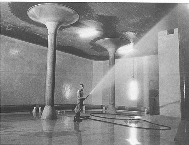
Wasserkammer Neues Reservoir Weiherweid
