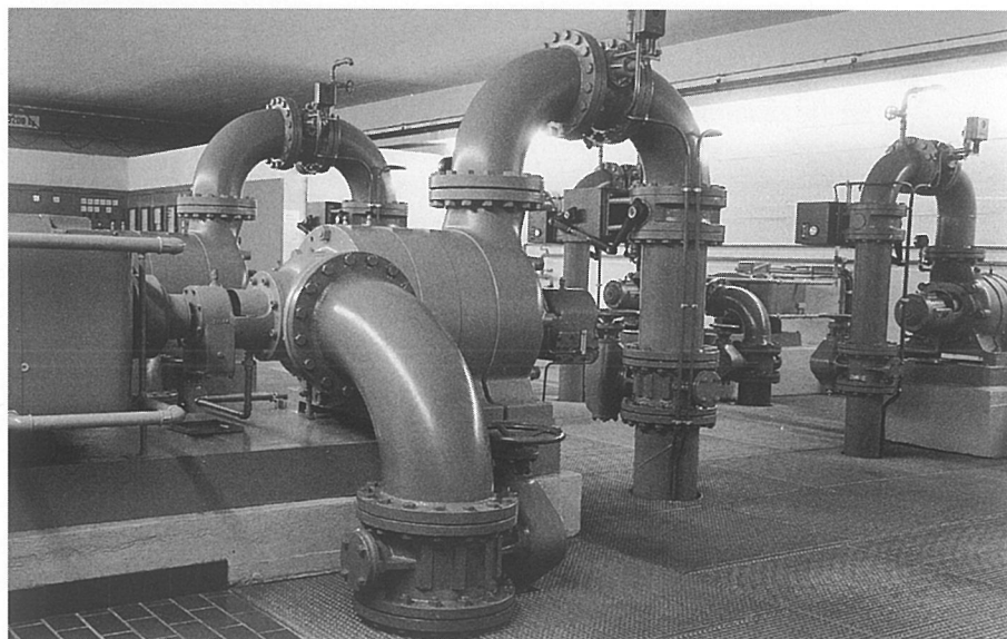
Pumpwerk Birmensdorf der Gruppenwasserversorgung Amt – Limmat – Mutschellen (GALM)
