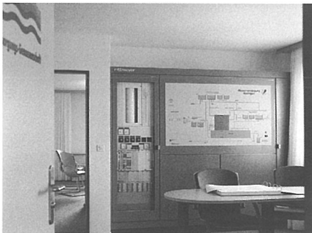
Neue Betriebswarte der Fernsteuerungsanlage im Werkgebäude
